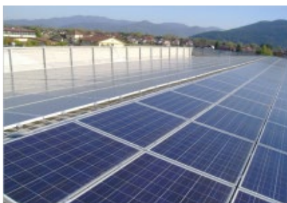
Slika 3: Sončna elektrarna Fortuna 240 kW na strehi zgradbe na Vrhniki (Vir: EPIA, 2013)
