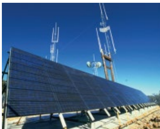
Slika 7: Sončna elektrarna, ki napaja telekomunikacijsko napravo (Vir: EPIA, 2013)
