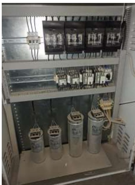
Slika 23: Sodobna naprava za kompenzacijo jalove energije na območju (Lastni vir)
