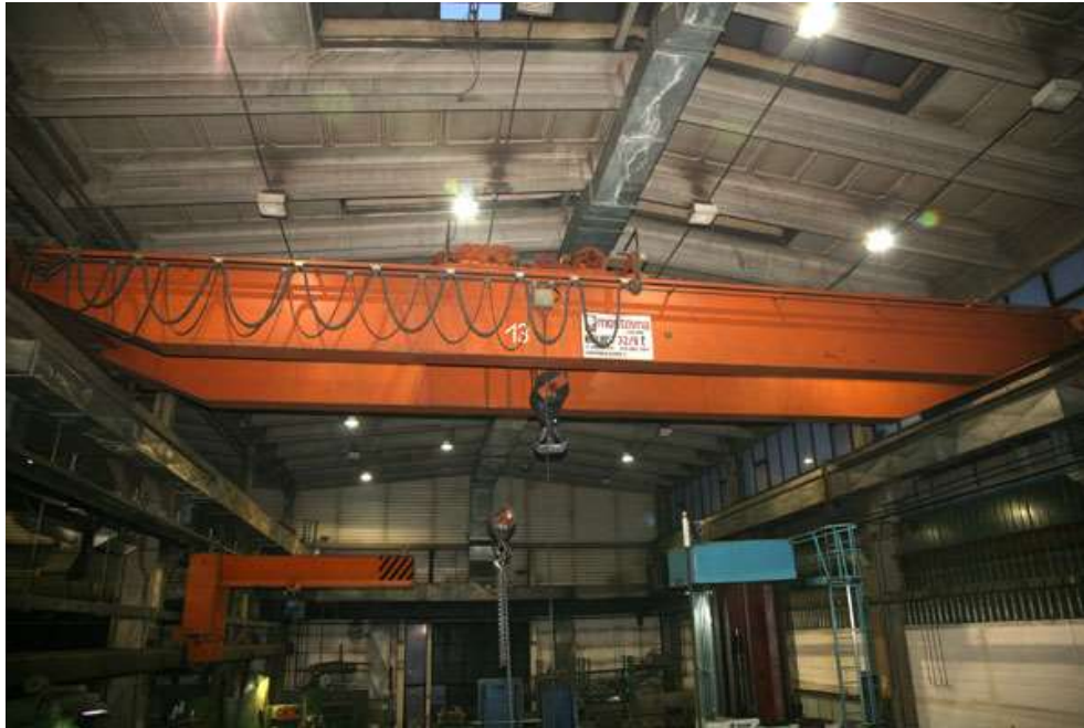
Slika 5: Mostovno dvigalo (Vir: RIKO KOR d.o.o., b. d.)
