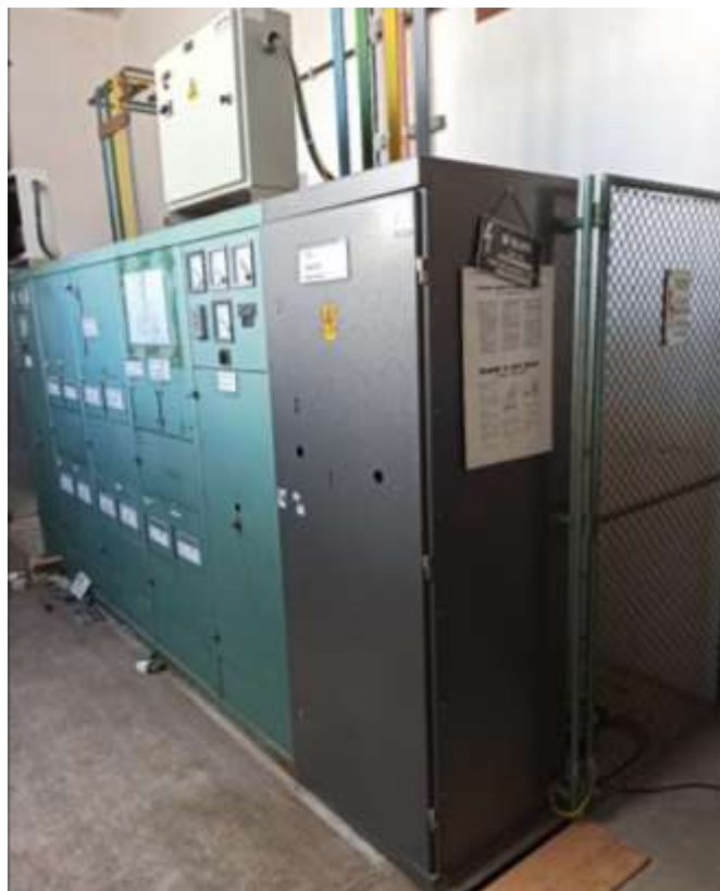
Slika 21: Merilni mesti podjetja RIKO KOR d.o.o. v transformatorski postaji (Lastni vir)
