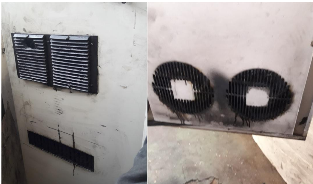
Slika 16: Vpliv okolja na ventilatorje (desno) in prezračevalne kanale (levo) (Lastni vir)
