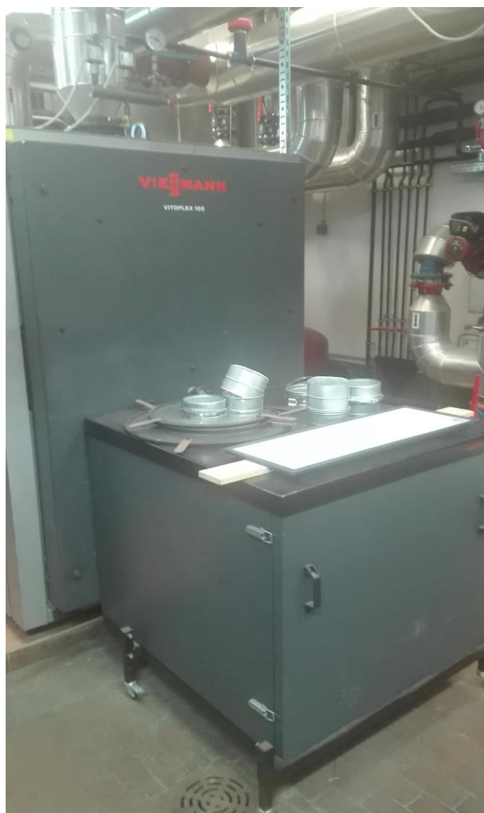
Slika 6: Kotlovnica Adria Tehnike (Lastni vir)
