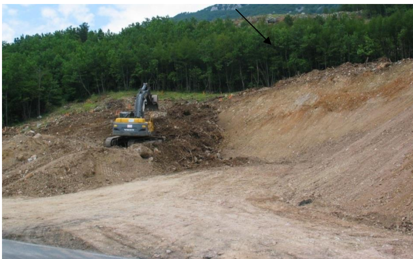
Slika 15: Del končane brežine, v ozadju posekano območje vkopa Polance (Vir: Interno gradivo SCT, 2005)
