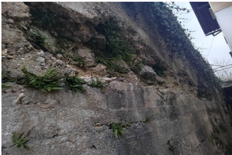
Slika 16: Razpadajoči oporni zid ob hiši (Lastni vir)
