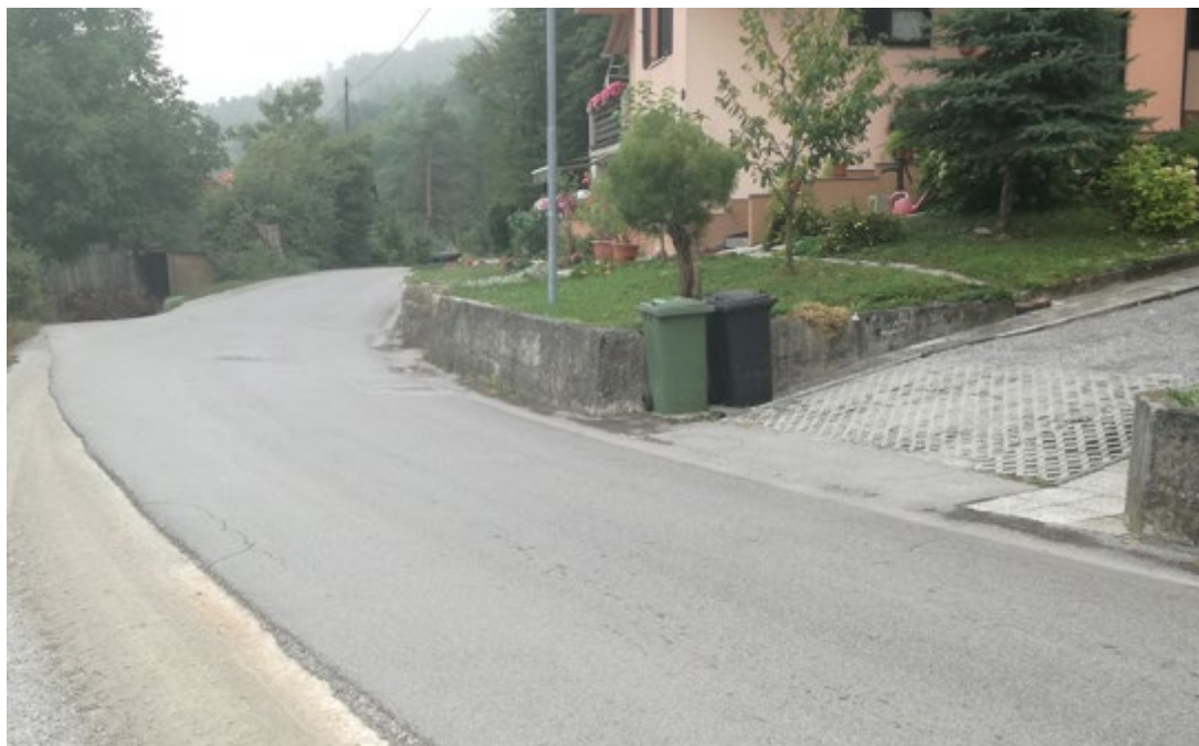
Slika 4: Nevarni odsek Zalarjeve ceste (Vir: Prometno varnostni načrt, 2021)
