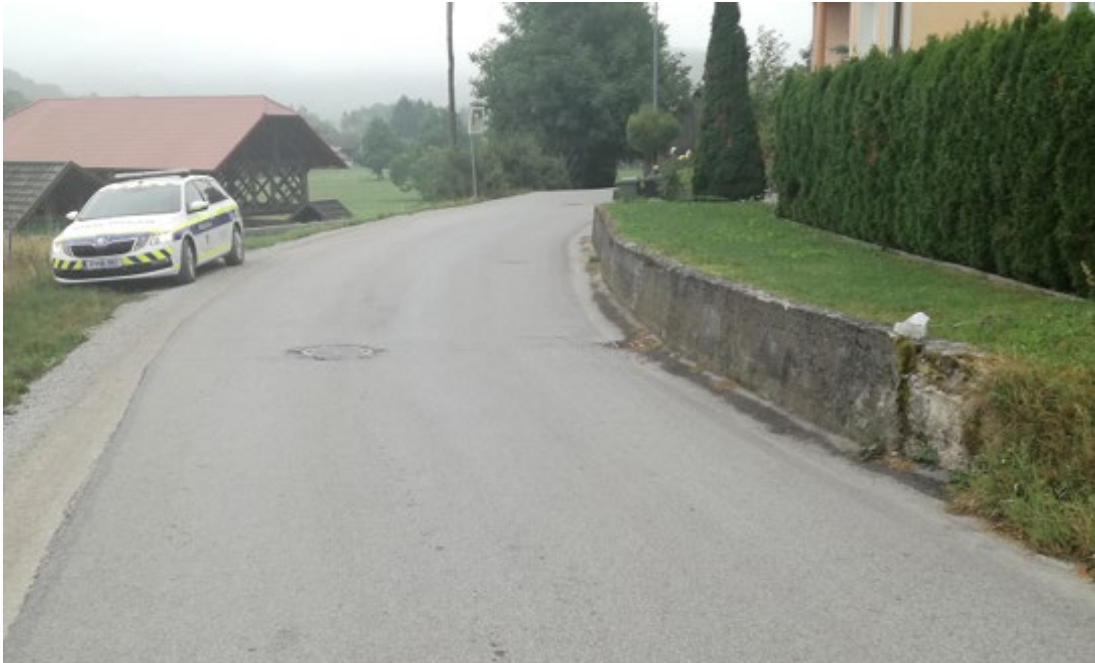
Slika 2: Nevarni odsek Zalarjeve ceste (Vir: Prometno varnostni načrt, 2021)
