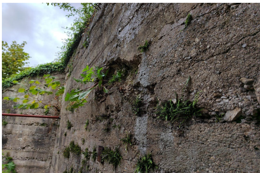
Slika 17: Razpadajoči oporni zid ob hiši (Lastni vir)
