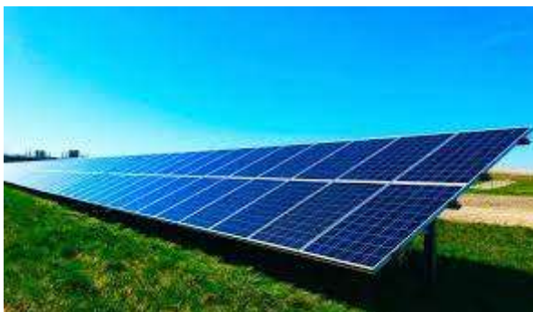
Slika 8: Prostostoječa sončna elektrarna (Vir: Elektro prodaja, 2022)
