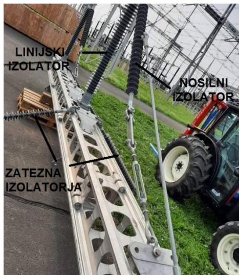
Slika 42: Izolatorji na montažnem stebru. (Lastni vir)
