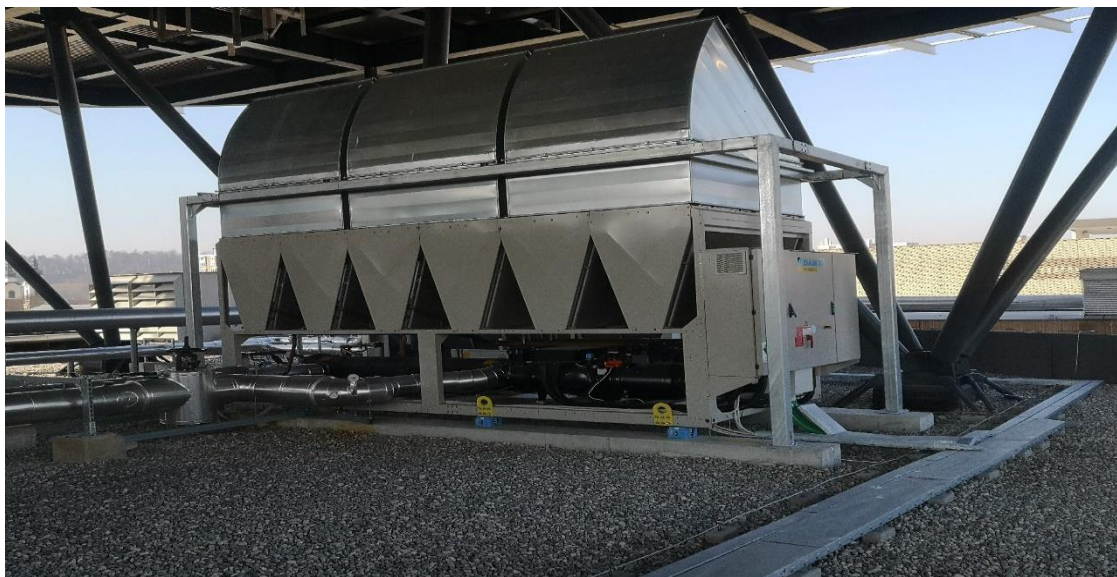
Slika 8: Zračno hlajeni agregat (Lastni vir)
