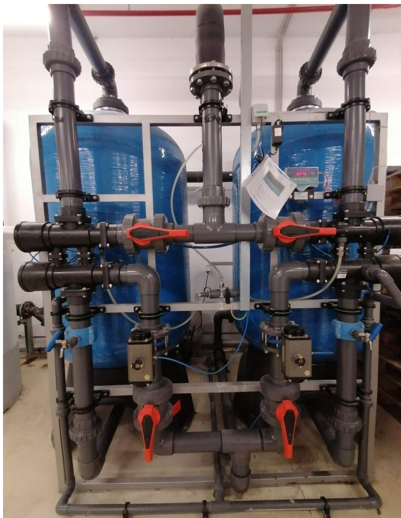
Slika 5: Naprava za mehčanje vode (Lastni vir)
