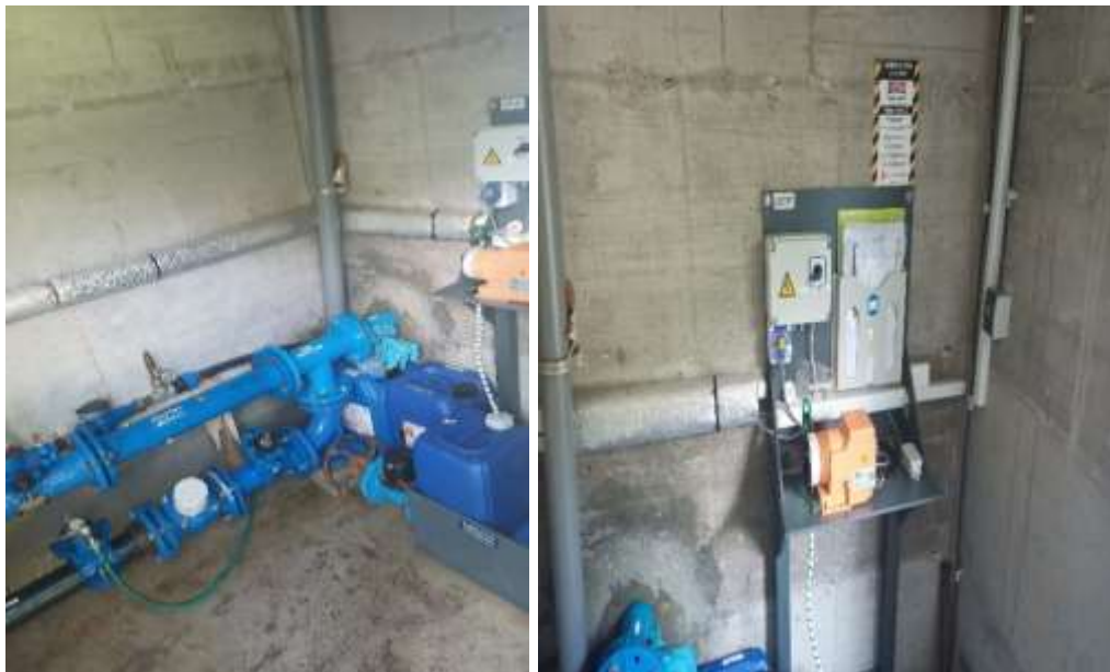
Slika 7: Notranjost klorirne postaje za vodovod Cirkuše - Mali Hribi (Lastni vir)
