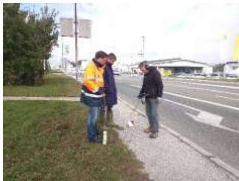
Slika 14: Iskanje puščanja vode s pomočjo Geofona Aqua M300 (Vir: ANDO TEHNA, d. o. o., 2023)
