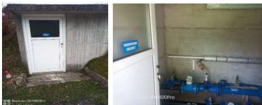
Slika 2: Vodovodni objekt za vaški vodovod Cirkuše - Mali Hrib (Vir: Avtorjev material, 2023)
