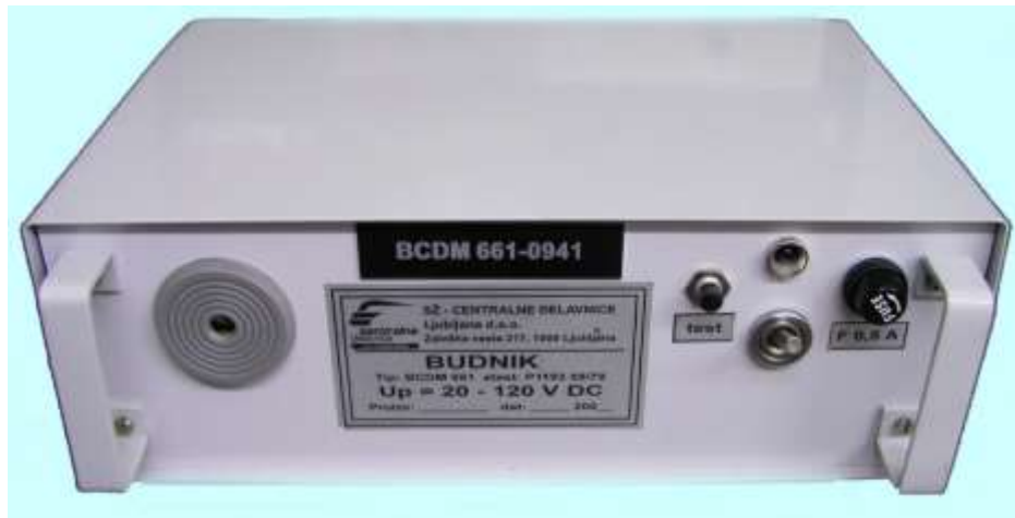
Slika 23: Vgrajen budnik tipa BCDM 661 v nizkonapetostni omari (Blejc, 2011, str. 14)
