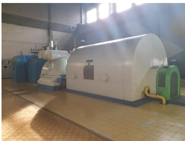
Slika 2: Turbinski agregat TA 1 (Lastni vir)
