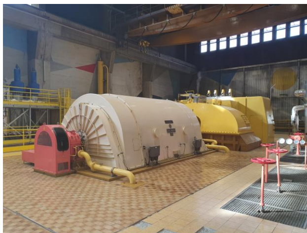
Slika 4: Turbinski agregat TA3 (Lastni vir)
