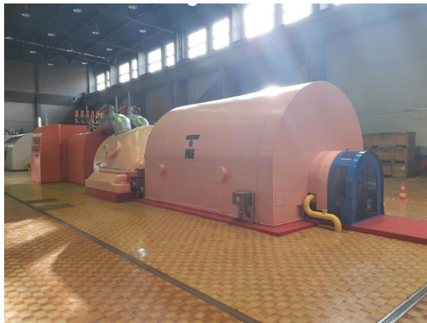
Slika 3: Turbinski agregat TA2 (Lastni vir)
