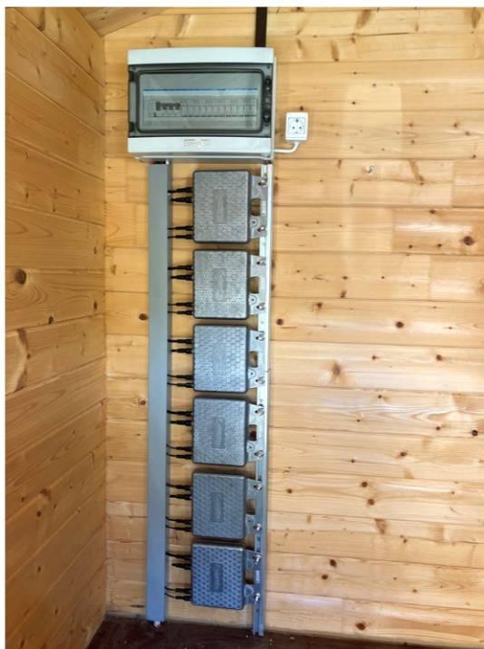
Slika 8: Sončna elektrarna izvedena z mikroinverterji proizvajalca Letrika (Lastni vir)
