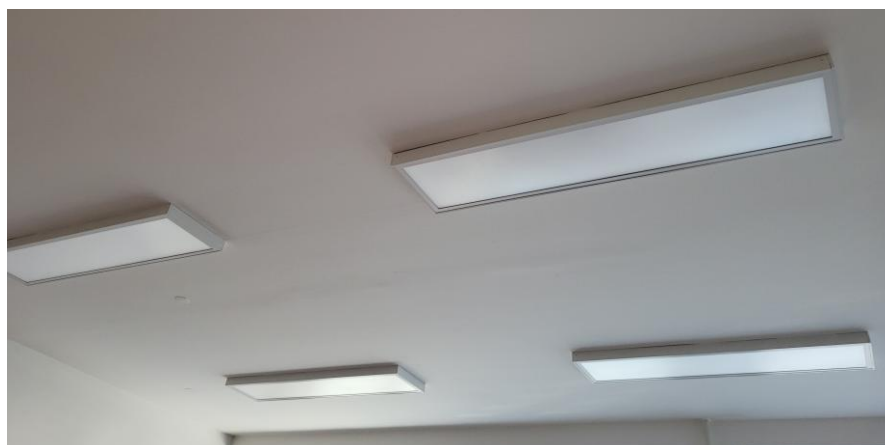
Slika 7: Primer LED-svetilke v poslovnem objektu po prenovi (Lastni vir)
