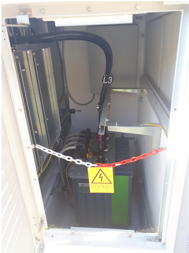
Slika 5: Transformatorski prostor (Vir: lasten)
