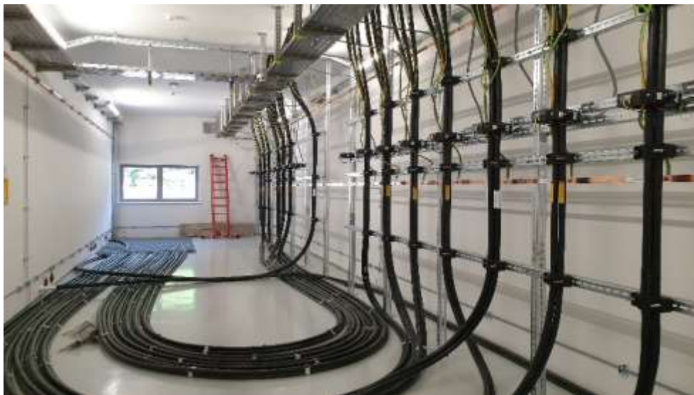
Slika 7: Kabelski prostor v R(T)P Vodenska (Lastni vir)
