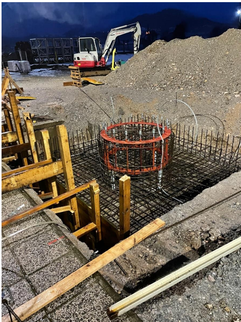
Slika 11: Pripravljalna dela temelja za nov dimnik in utrjevanje terena za dvigalo (Lastni vir)
