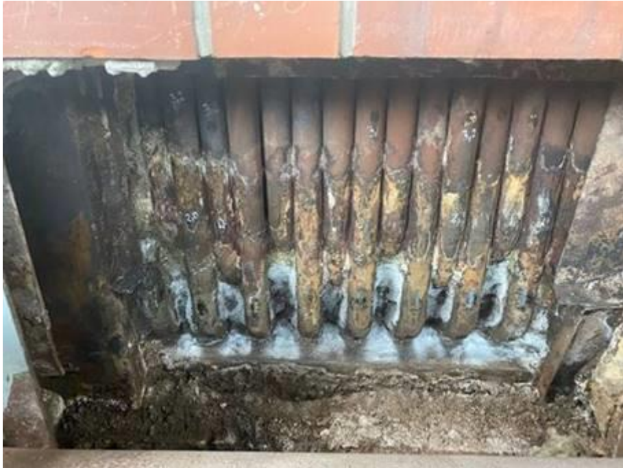
Slika 4: Prikaz poškodbe/obrabe kotla (Vir: Podjetje X, 2021)
