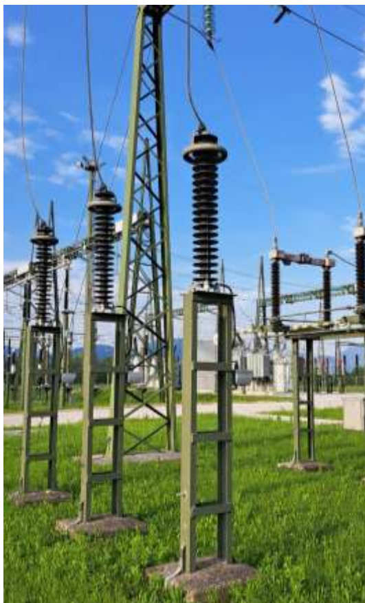
Slika 14: Prenapetostni odvodniki (Lastni vir)
