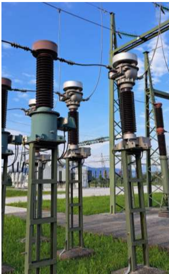
Slika 13: Tokovni in napetostni transformatorji v DV polju (Lastni vir)
