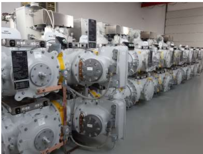
Slika 19: 110 kV stikališče v GIS izvedbi (Lastni vir, 2022)
