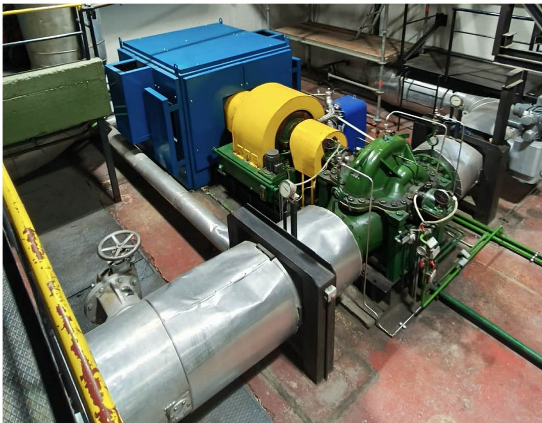
Slika 7: Obstoječi črpalni agregat 2/5 s hidravlično sklopko (Lastni vir)
