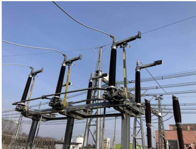
Slika 6: Ozemljevanje z ozemljitvenimi noži 110kV (Lastni vir)
