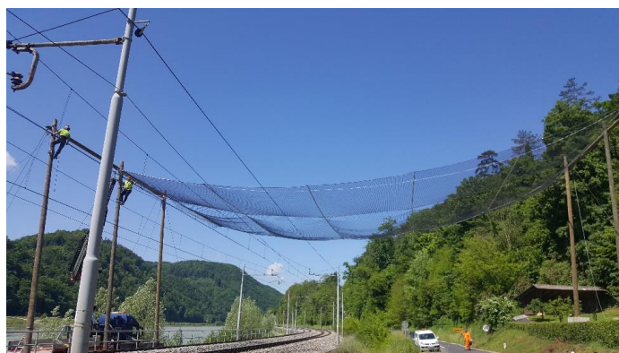
Slika 23: Lovilna mreža nad železniško progo (Lastni vir)
