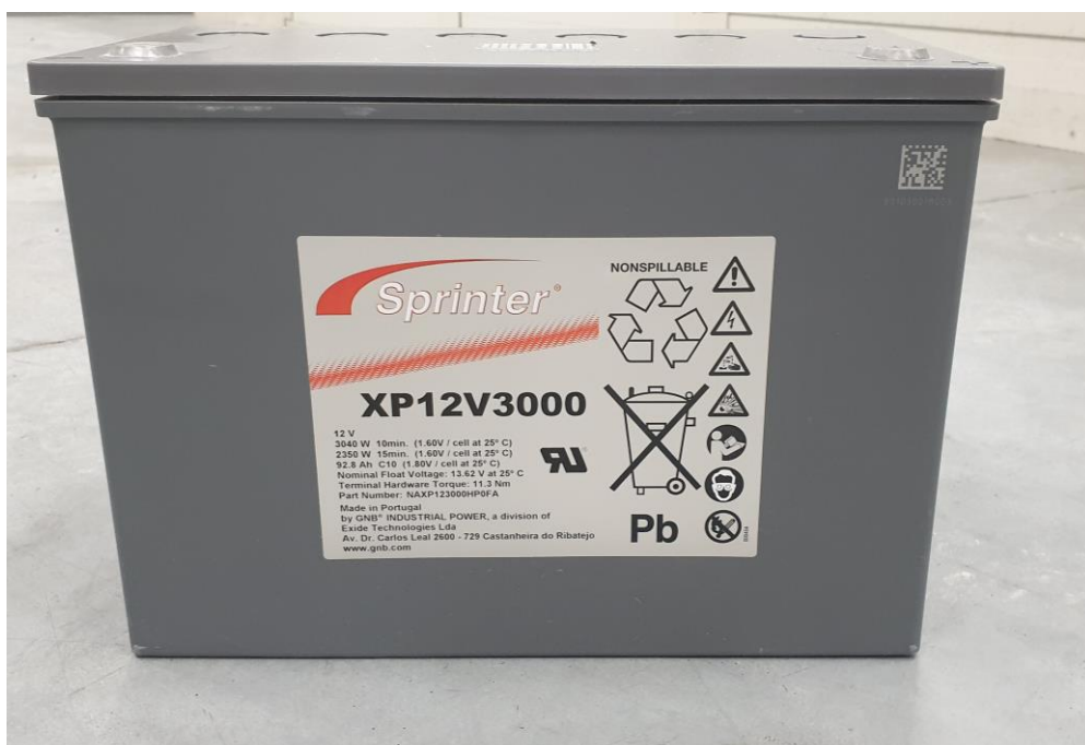
Slika 25: Ena izmed baterij, vgrajenih v napravi UPS (Lastni vir)
