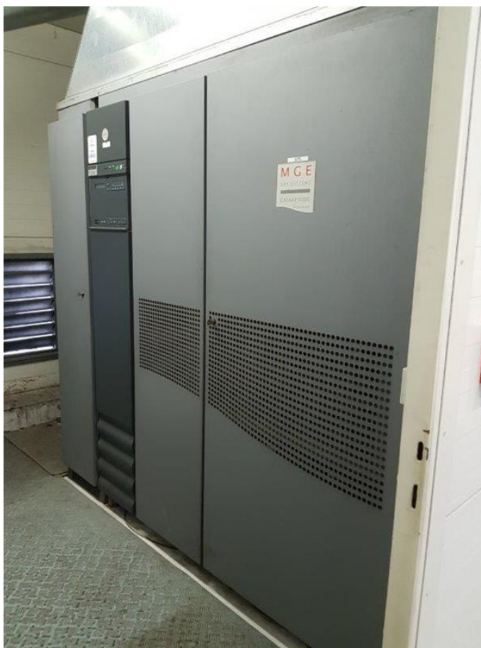
Slika 24: Naprava UPS MGE Galaxy 6000, 500 kVA (Lastni vir)
