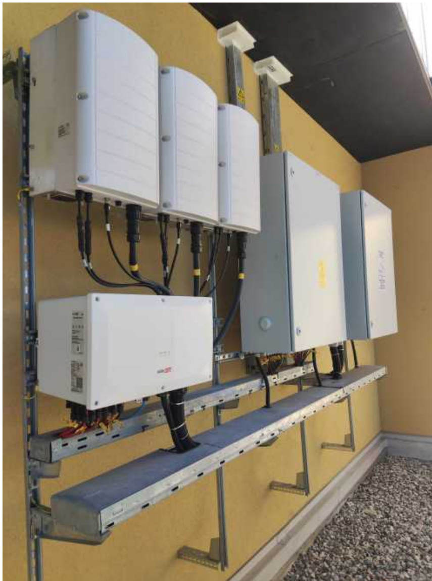
Slika 9: SolarEdge razsmerniki na SE Ježica (Lastni vir)
