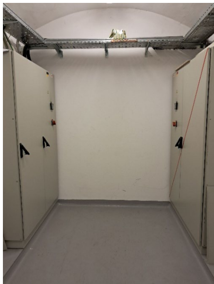
Slika 12: Razvod UPS – Stara ginekološka klinika (Lastni vir)
