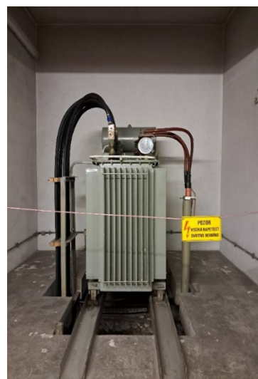
Slika 5: Transformator (Lastni vir)
