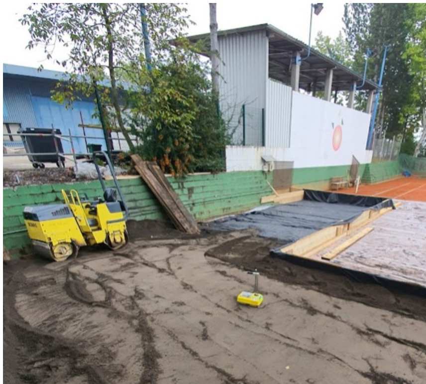
Slika 9: Izdelava testnega polja v postopku registracije pepela in žindre kot stranski proizvod (Lastni vir)
