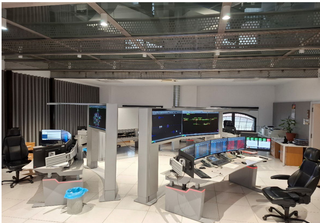
Slika 3: Center vodenja Elektro Ljubljana (Lastni vir, 2024)
