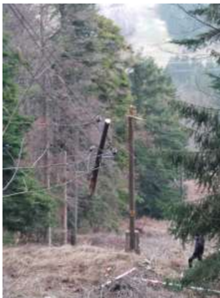
Slika 21: Zlomljen nosilni drog (Lastni vir)
