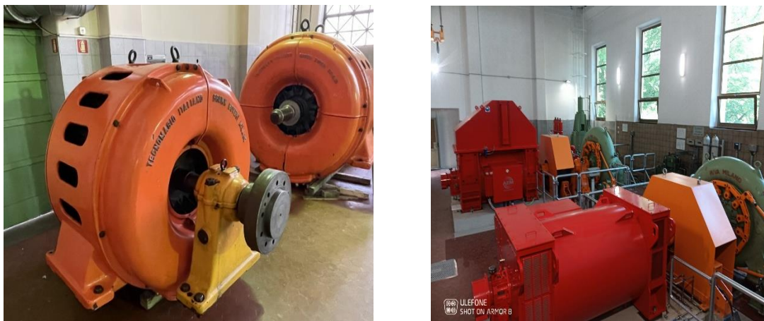
Slika 4: Star in nov generator mHE Hubelj (Lastni vir)
