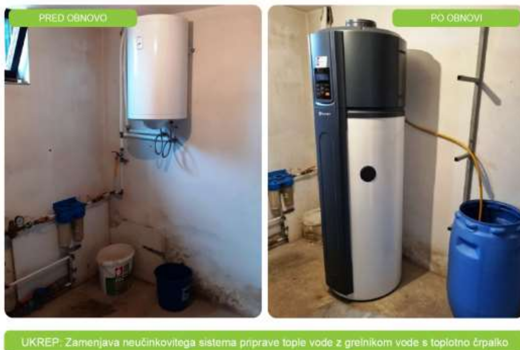
Slika 4: Pred in po zamenjavi el. grelnika z toplotno črpalko. (Vir: Eko sklad, 2023)
