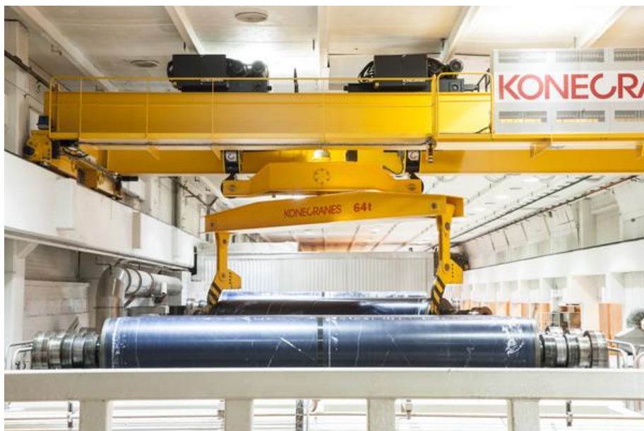
Slika 25: Primer tipsko izdelanega in prirejenega mostnega dvigala v papirni industriji (Vir: www.konecranes.com )
