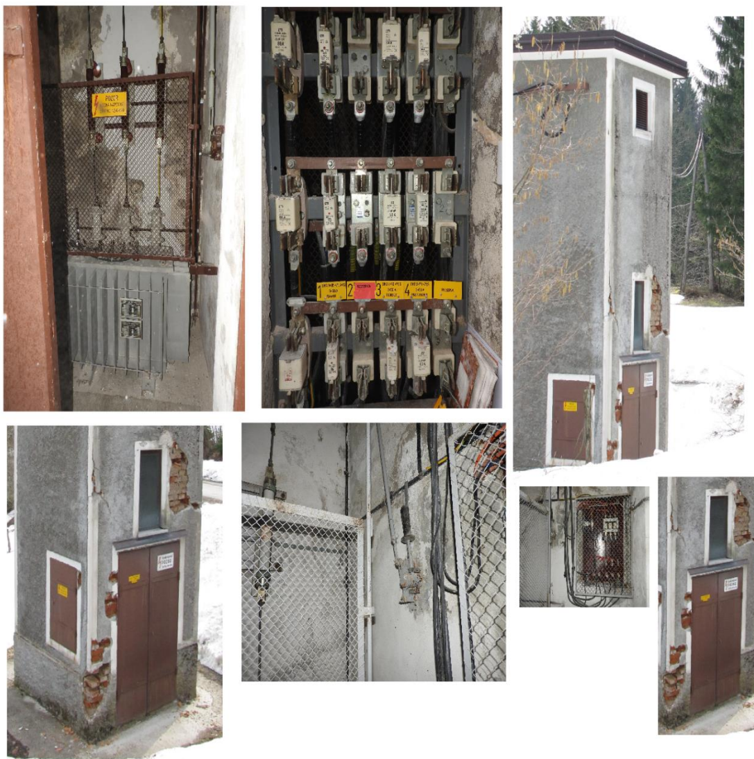
Slika 2: Pomanjkljivosti stolpne transformatorske postaje (Lastni vir)
