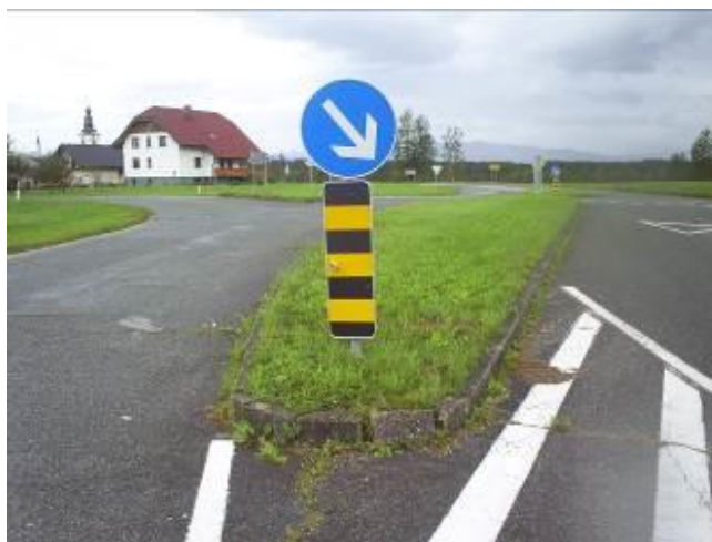
Slika 29: Prometna signalizacija (Vir: lasten)
