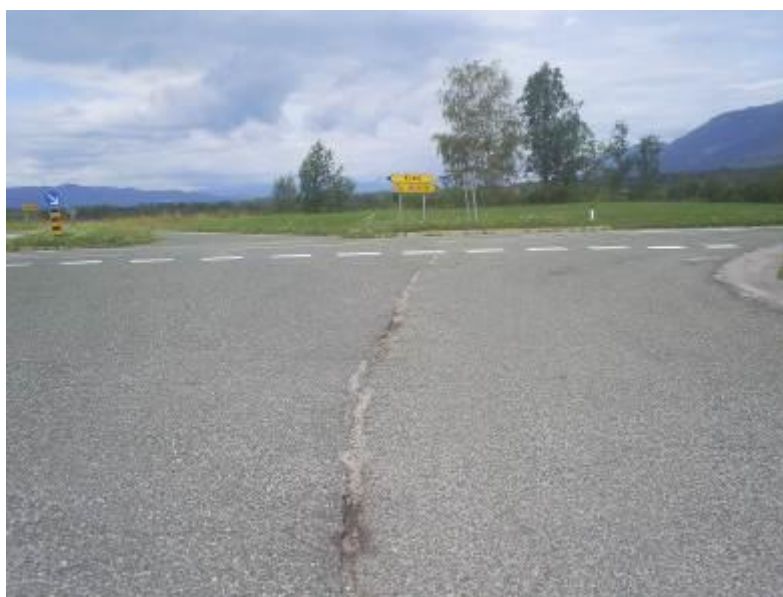
Slika 25: Stanje voziščne konstrukcije (Vir: lasten)
