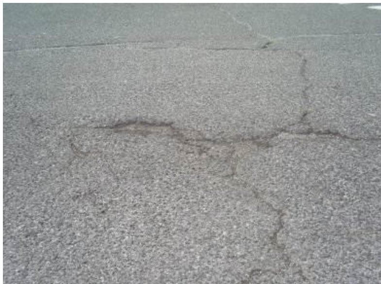
Slika 23: Stanje voziščne konstrukcije (Vir: lasten)
