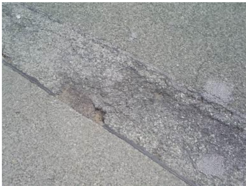
Slika 24: Stanje voziščne konstrukcije (Vir: lasten)
