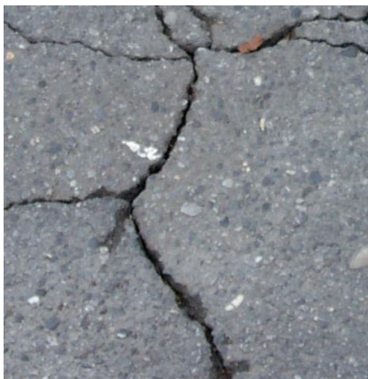
Slika 7: Razpoke, kjer so spremembe materialov v podlagi (Vir: TSC 08.311/1: 2005; redno vzdrževanje cest, vzdrževanje prometnih površin, asfaltna vozišča)
