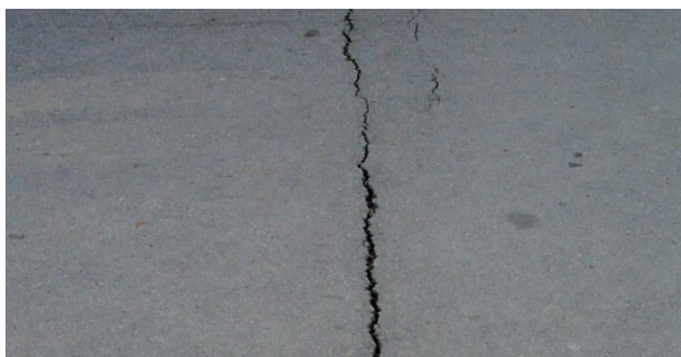
Slika 9: Razpoke na večjih asfaltnih površinah (Vir: TSC 08.311/1: 2005; redno vzdrževanje cest, vzdrževanje prometnih površin, asfaltna vozišča)
