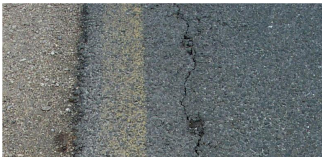
Slika 8: Razpoke na vozni površini ter ob razširitvi (Vir: TSC 08.311/1: 2005; redno vzdrževanje cest, vzdrževanje prometnih površin, asfaltna vozišča)
