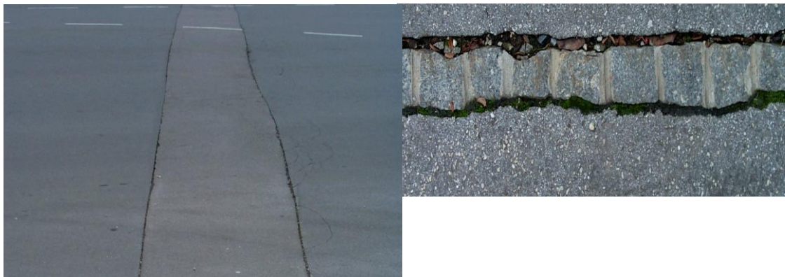
Slika 4: Razpoke na stikih različnih asfaltnih zmesi in plasti
