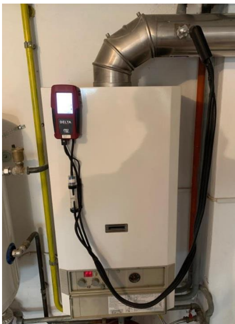
Slika 35: Merjenje dimnih plinov na nizekotemperaturnem kotlu (Lastni vir)
