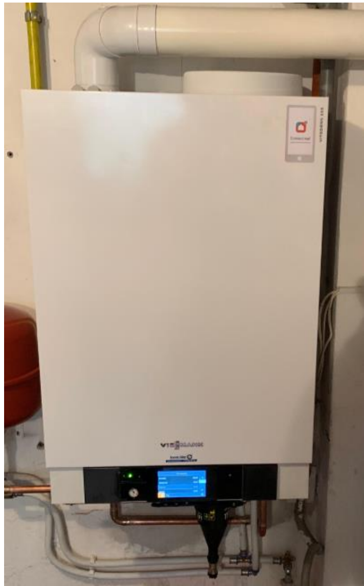
Slika 10: Kondenzacijski kotel (Lastni vir)
