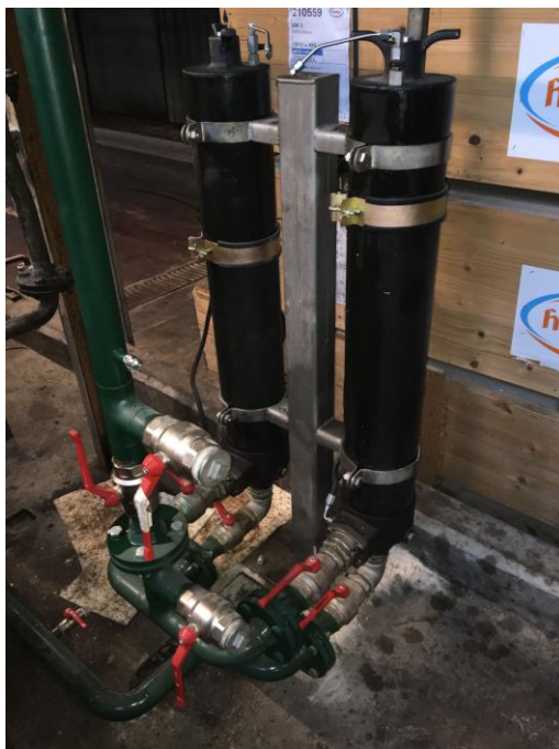
Slika 38: Filter – HYPRO, ohišje F8 s filtrom HP107 (Vir: Dimas d. o. o., 2020)
