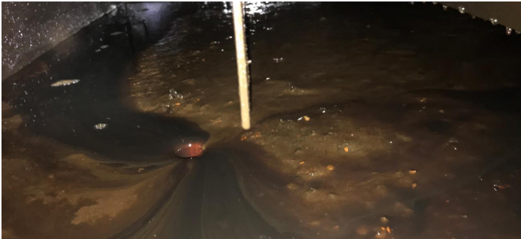
Slika 46: Izpust olja in usedline na dnu rezervoarja (Vir: Dimas d. o. o., 2020)
