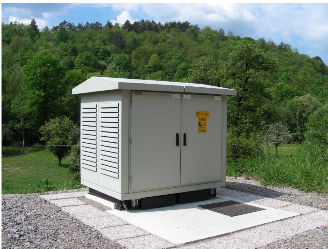
Slika 15: Transformatorska postaja MHE Žagar (Lastni vir)
