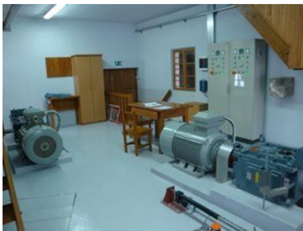
Slika 13: Notranji del MHE Žagar (Vir: Hydro hit, 2020)
