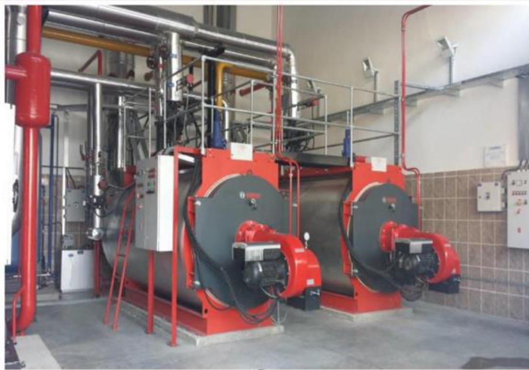
Slika 31: Novi kotel 2 × 3,5MW za Bačko Palanko (Vir: Beogradske Elektrane, predstavitev učinkov projekta optimizacije Sistema daljinskega ogrevanja)
