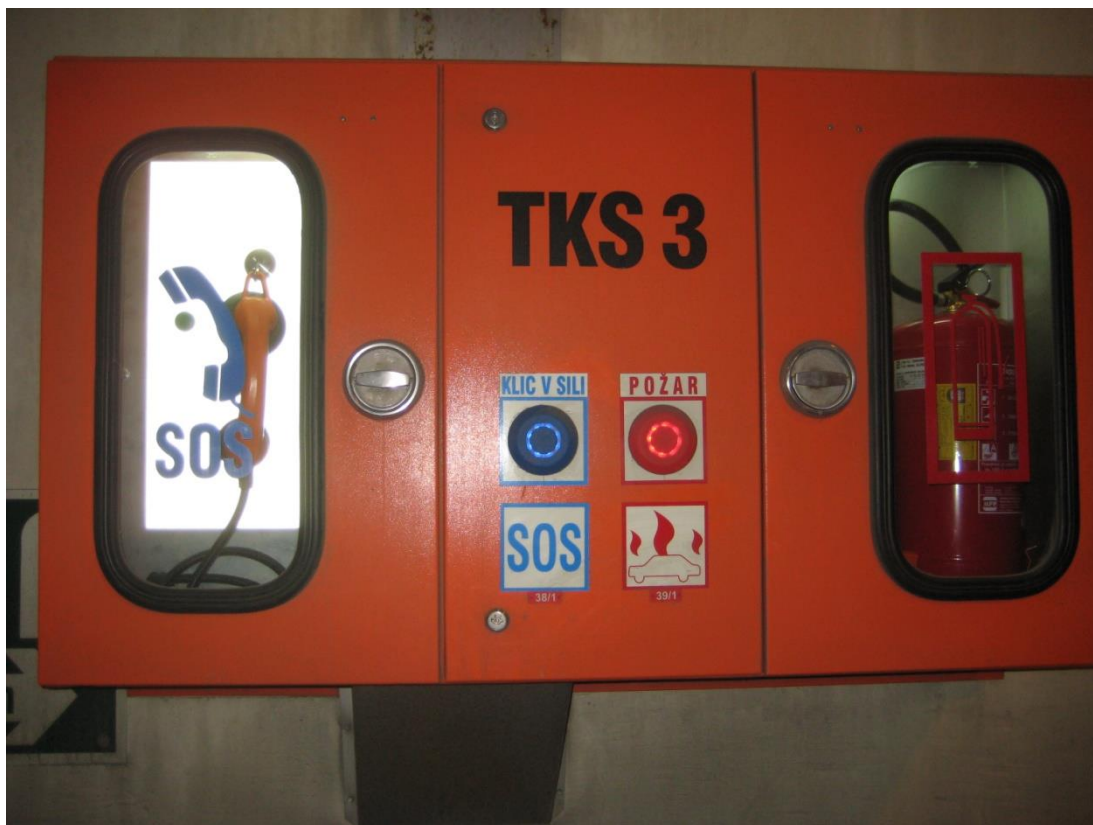
Slika 5: Omarica v predoru z gumbom za klic v sili, požar, s telefonom in gasilnim aparatom (Vir. Lasten)
