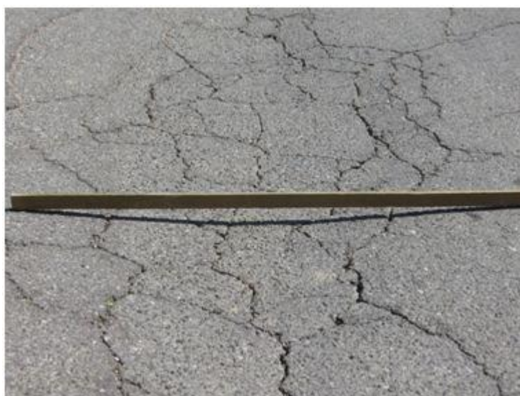
Slika 8: Mrežna poškodba (Vir: MK Inženiring, 2019)
