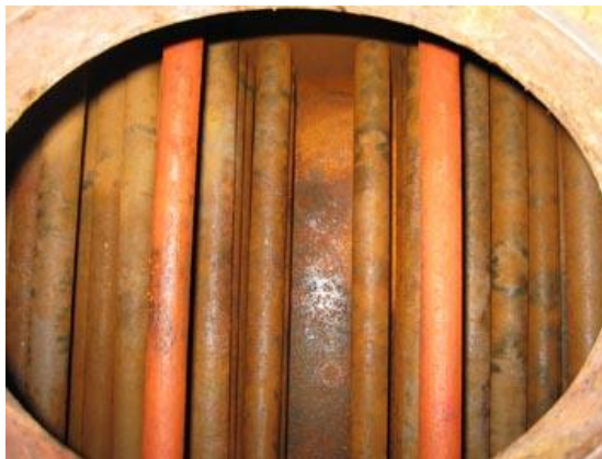
Slika 6: Površinska korozija na vodni strani dimnih cevi
