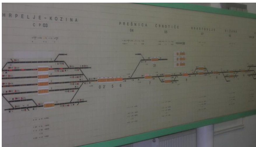
Slika 30: Nadzorna panoramska plošča s svetlobnimi javljalniki v centru telekomande
