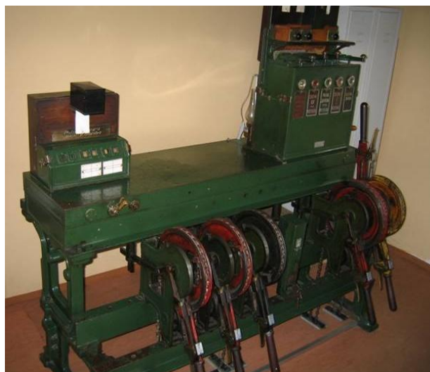
Slika 14: Kretniški blok z električno nadgradnjo
