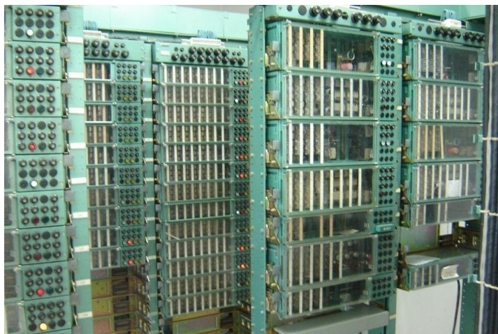
Slika 17: Stojala z relejnimi skupinami v relejnem prostoru ERSV naprav (Vir: http://shrani.si/f/1r/Zi/3uJM2Vdj/dsc09254.jpg )
