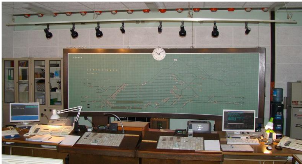
Slika 32: Centralna postavljalnica z nadzorno ploščo in številčnimi postavljalnimi pultoma (Vir: Kristijan Matko, 2012)
