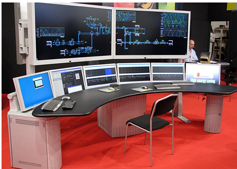
Slika 34: Elektronska postavljalnica v centru vodenja prometa (simbolna slika) (Vir: http://www.vlaki.info/slike/2010_12_13/2010_12_13_02.jpg )
