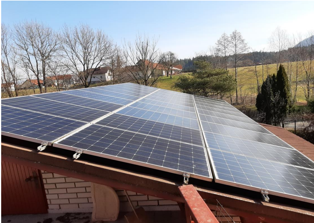
Slika 11: Fotonapetostni moduli na strehi (Vir: lastni)
