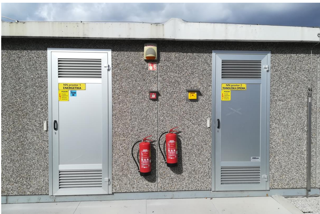
Slika 13: Obstoječa transformatorska postaja TP-2, 2 x 1000 kVA v CČN Kranj (Vir: Lastni, december 2018)
