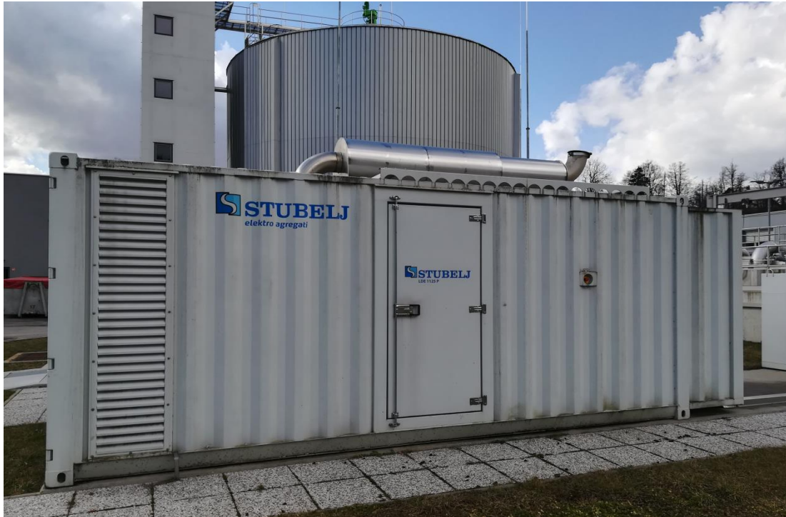
Slika 12: Obstoječi 1020 kW rezervni dizelski generator v CČN Kranj (Vir: Lastni, december 2018)
