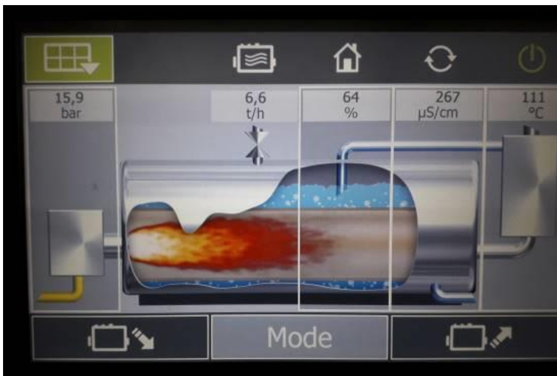
Slika 7: Zaslona; obratovanja parnega kotla (Lastni vir)
