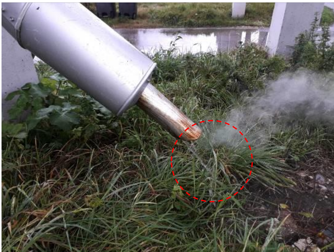
Slika 4: Izpust kondenzata (Lastni vir)
