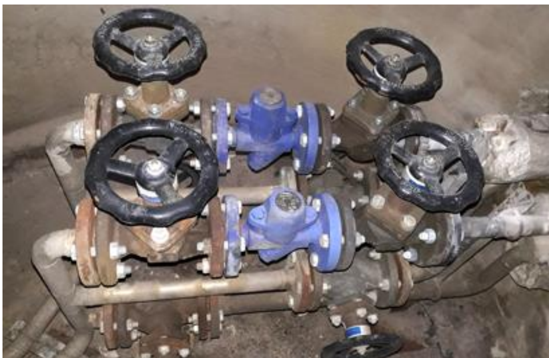
Slika 17: Odvajalniki kondenzata v jašku (Lastni vir)
