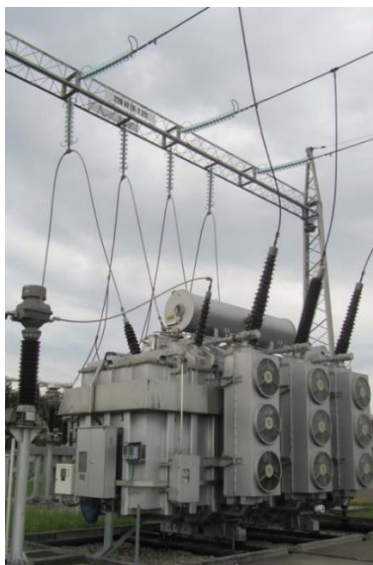
Slika 1: Energetski transformator (vir: Eles, 2000)
