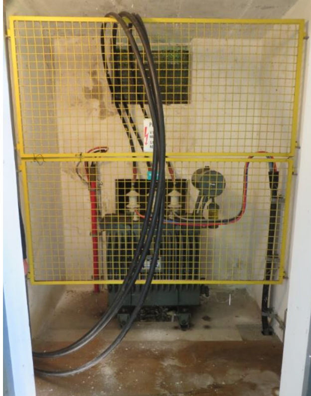
Slika 1: Transformator v TP T250 – Blejski otok-leto izdelave 1970 (Vir: Elektro Gorenjska, 2015)
