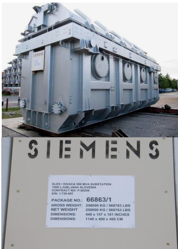
Slika 16: Transformator za transformatorsko postajo Divača Vir: Slovenske železnice, d. o. o., Ljubljana 2011
