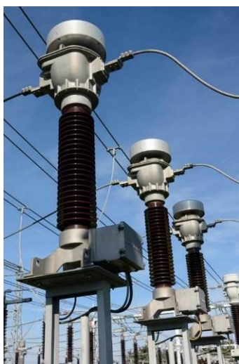
Slika 9: Tokovni merilni transformator, 110 kV (Lastni vir)
