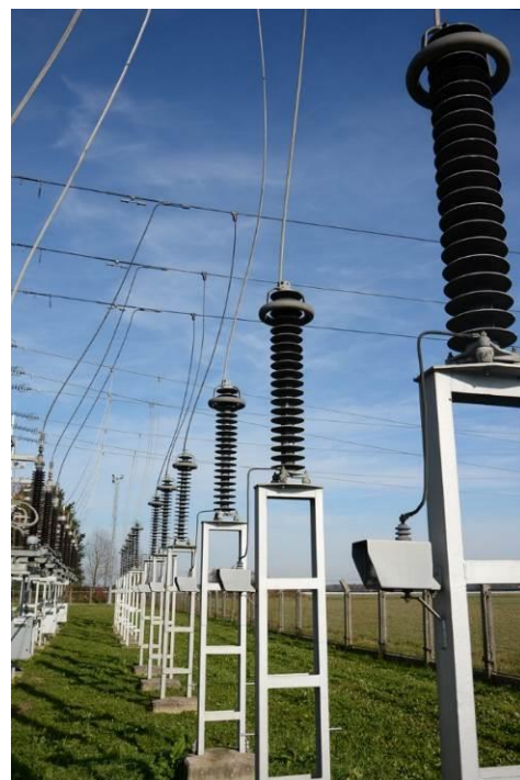
Slika 12: Odvodnik prenapetosti, 110 kV (Lastni vir)
