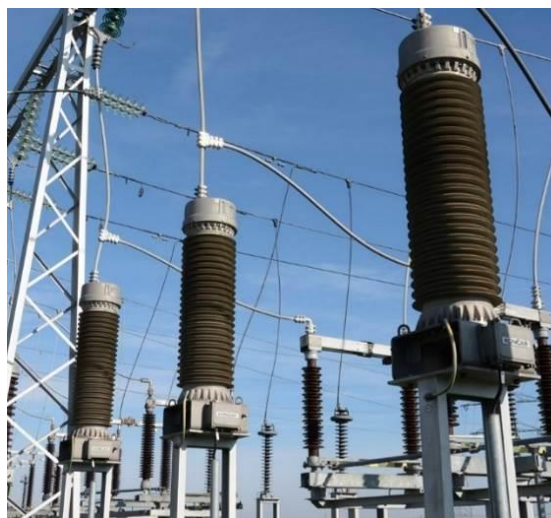
Slika 10: Napetostni merilni transformator, 110 kV (Lastni vir)
