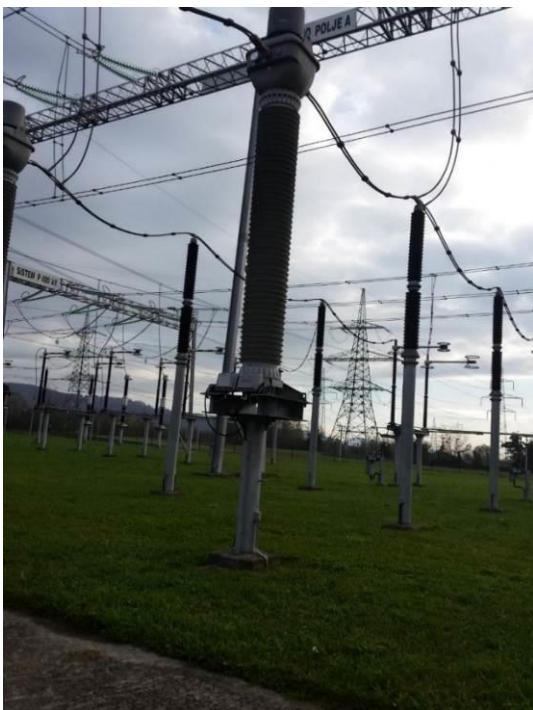
Slika 11: Kombinirani merilni transformator, 400 kV (Lastni vir)
