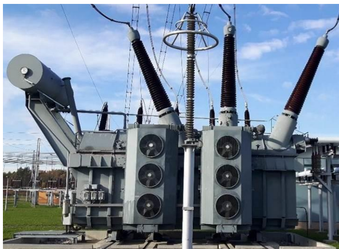
Slika 5: Trifazni transformator v RTP Maribor – 400 kV na 110 kV (Lastni vir)
