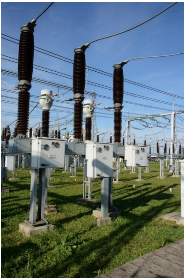
Slika 8: Odklopnik, 110 kV (Lastni vir)
