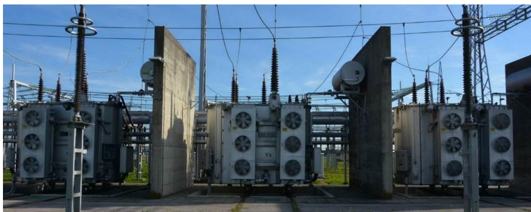
Slika 4: Enofazni transformatorji v RTP Cirkovce – 220 kV na 110 kV (Lastni vir)
