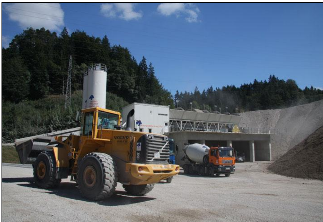
Slika 4: Betonarna Podbrezje (Vir: www.cpkranj.si/beton.html )
