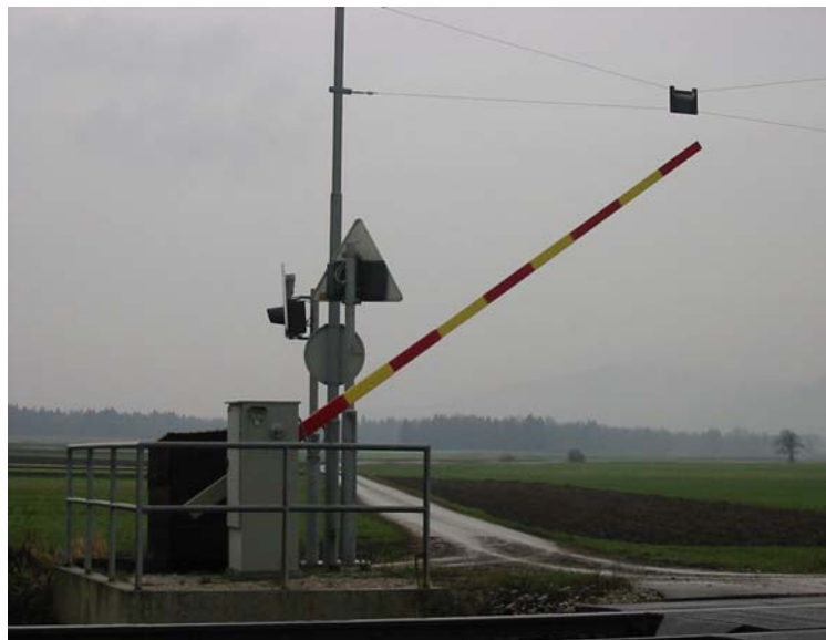
Slika 38: Avtomatska zapornica in naprava za vklop zapornic.
