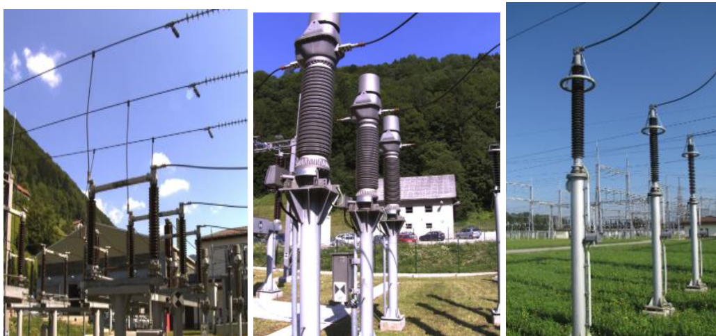
Slika 7: ločilniki, instrumentalni transformatorji, odklopniki Eles. (b.l.)
